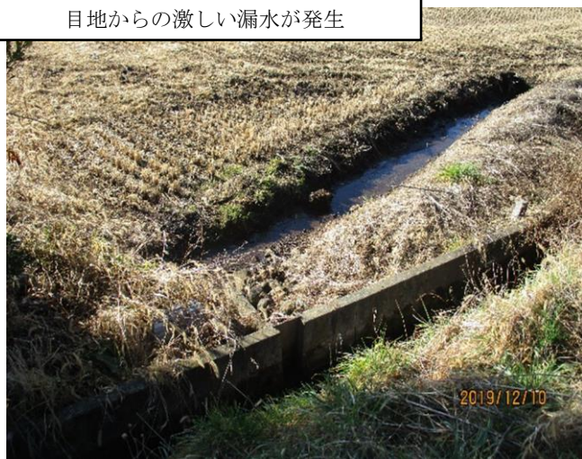
目地からの激しい漏水が発生
