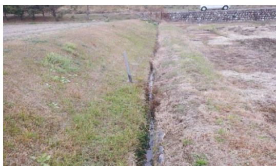
【土水路の機能診断（法面の浸食・漏水）】
