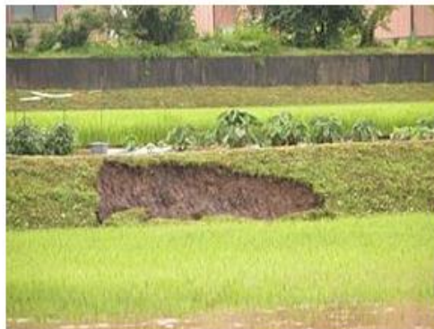
法面の崩壊状況
