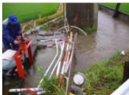
ゲートへのごみや流木の流入状況
