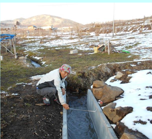
【水路竣工検査の実施】 素掘り水路からコンクリート水路への更新を実施しました。
