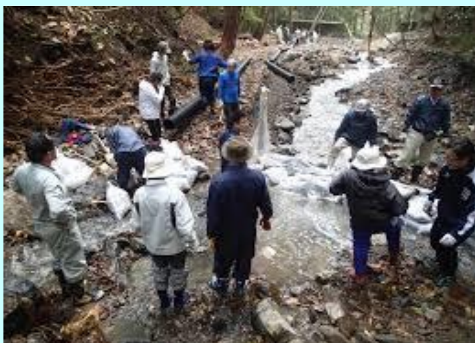
配水地を管理している様子
