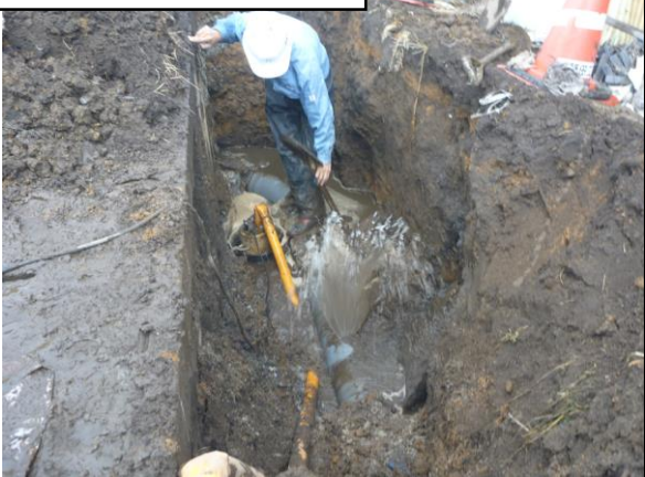
送水管の漏水が発生
