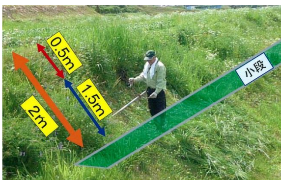
法面に小段を設けて足場を確保して草刈(1.5m分は小段から、0.5m分は上から)
