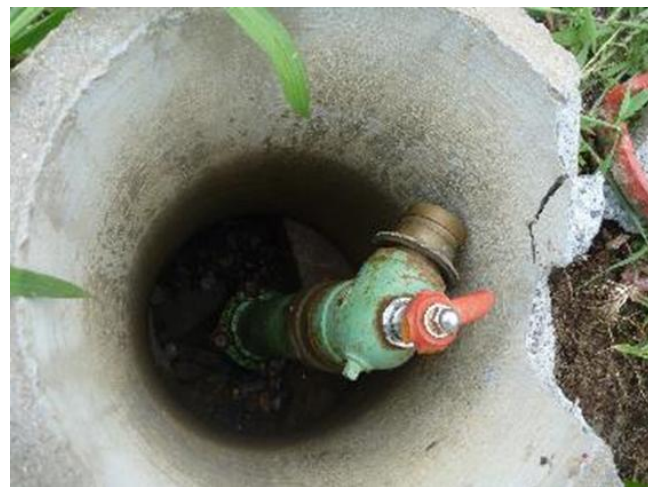
破損した給水栓バルブ
