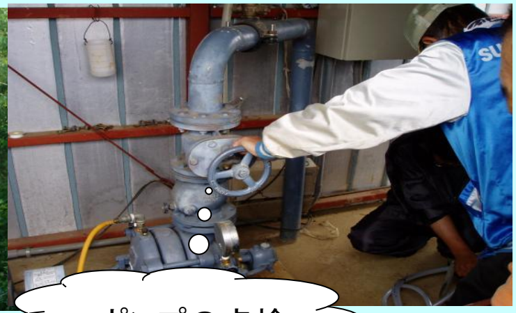
ポンプの点検
