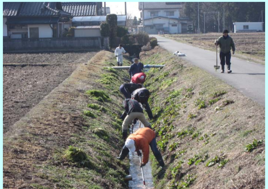
川に堆積した土砂の片づけ
