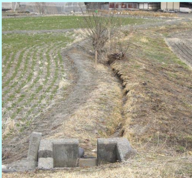
崩壊が進む素掘り水路
