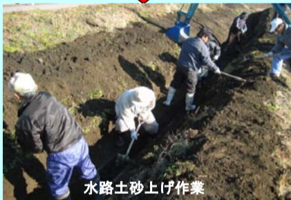
土砂の溜まった水路
