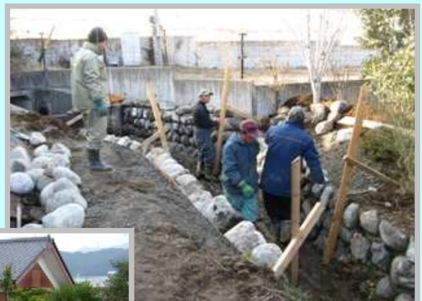
水路の補修 経験者を含めた構成員で玉石積の補修を実施
