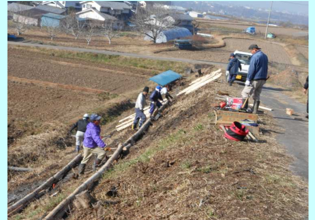
草刈りを容易にするため、畦畔に小段を設置しています。
