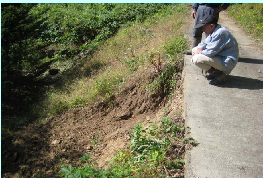
台風による農道崩落現場の点検・確認作業
