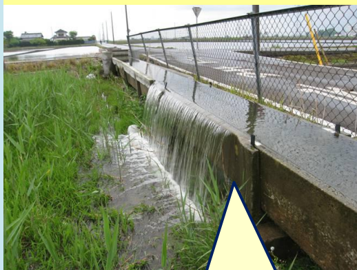
沈下による溢水
