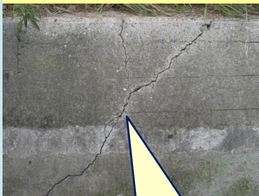
斜め方向のひび割れ
