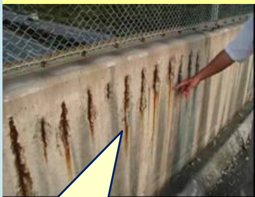
狭い間隔のひび割れ
