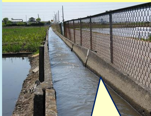
沈下による変形
