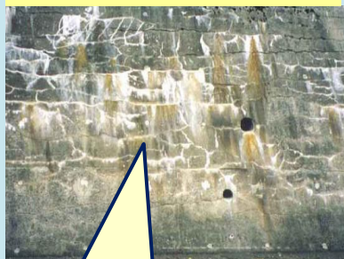
亀甲状・網目状のひび割れ
