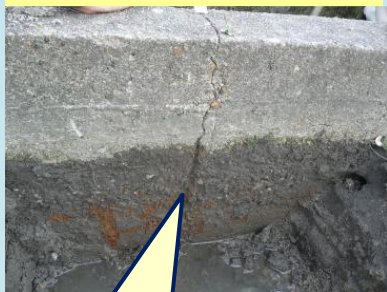
縦方向のひび割れ
