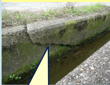
段差のあるひび割れ
