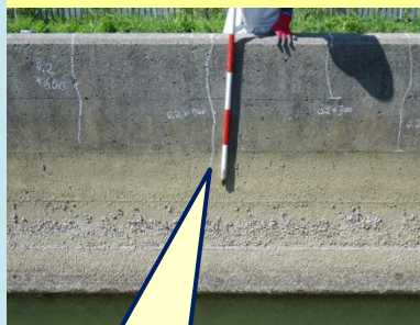
縦方向のひび割れ
