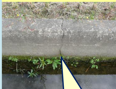
縦方向のひび割れ
