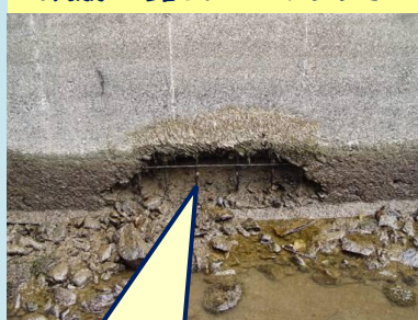
鉄筋が露出した穴あき
