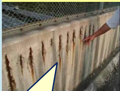
狭い間隔のひび割れ
