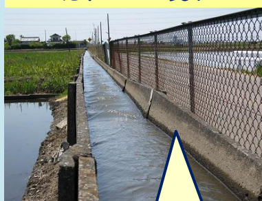
沈下による変形
