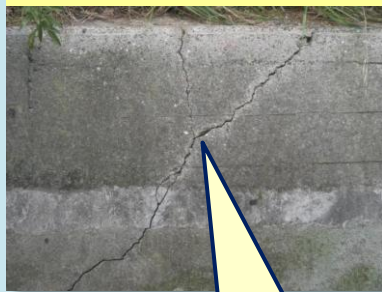
斜め方向のひび割れ
