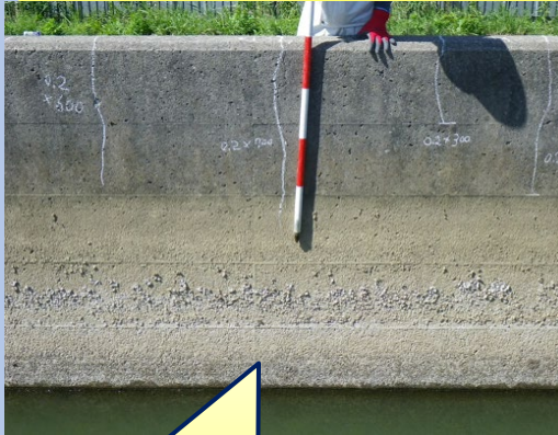
縦方向のひび割れ
