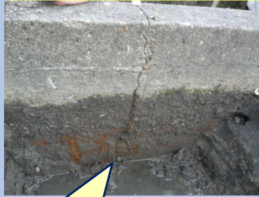
縦方向のひび割れ
