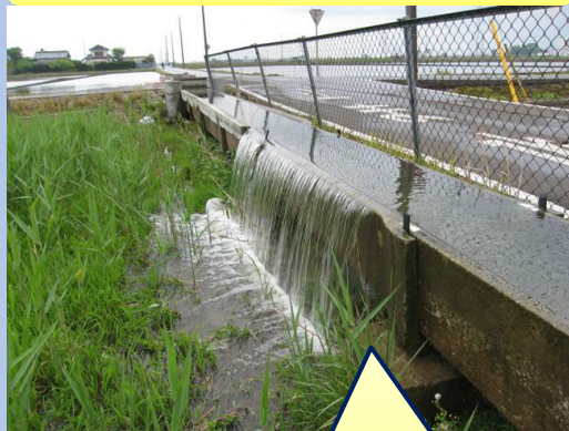
沈下による溢水
