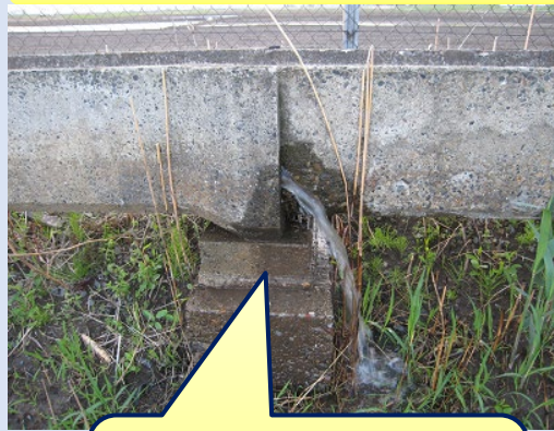
目地の開き (漏水)
