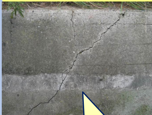
斜め方向の割れ
