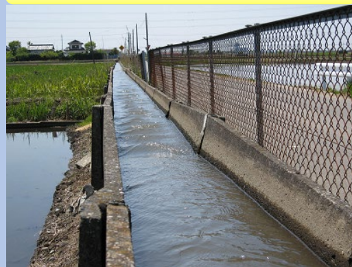
沈下による変形
