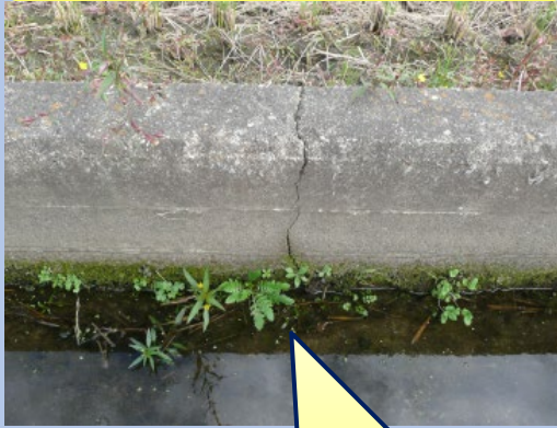
縦方向のひび割れ
