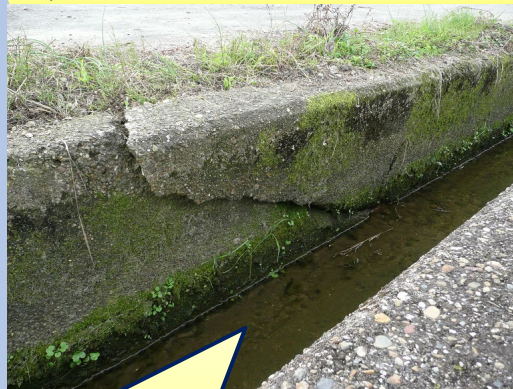
段差のあるひび割れ
