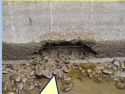
鉄筋が露出した欠損
