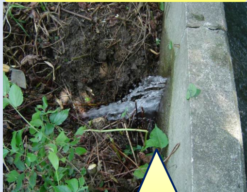
目地の開き (漏水)
