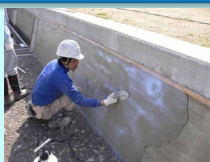
老朽化した水路壁の 表面被覆
