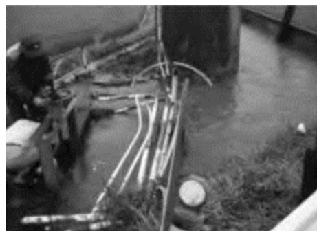
ゲートへのごみや流木の流入状況
