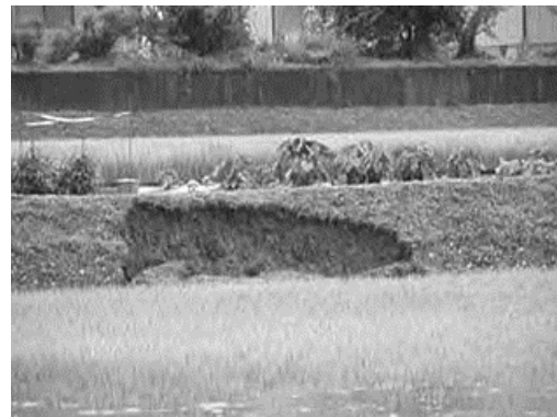
法面の崩壊状況
