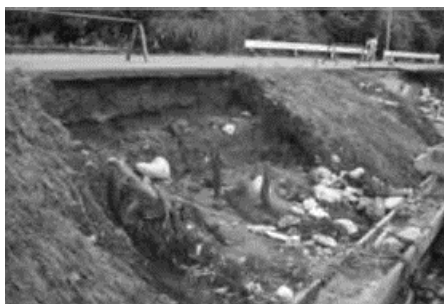
道路法面の崩壊状況
