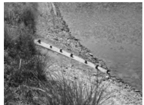
斜樋と取水栓
